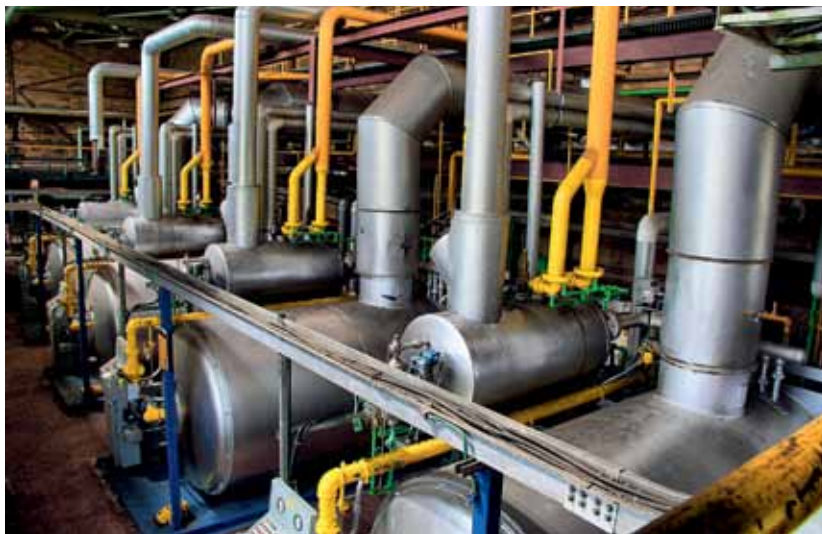
ПОТЕНЦИАЛЬНО ОПАСНЫЕ ОБЪЕКТЫ ПО-ПРЕЖНЕМУ В ЗОНЕ ВНИМАНИЯ ТЕХНИЧЕСКОГО НАДЗОРА
