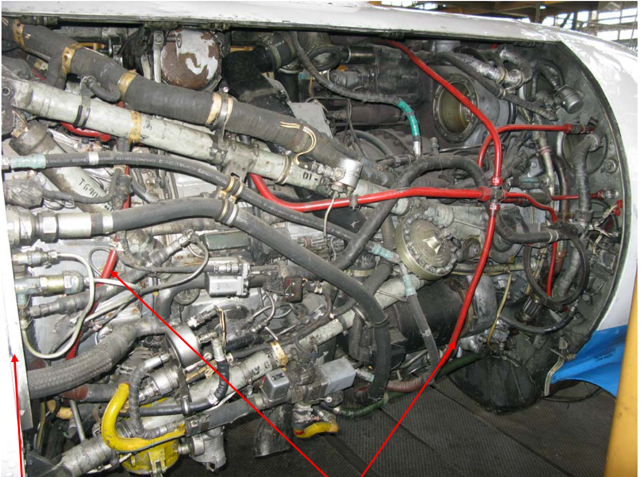
Распылительные трубопроводы противопожарной системы
